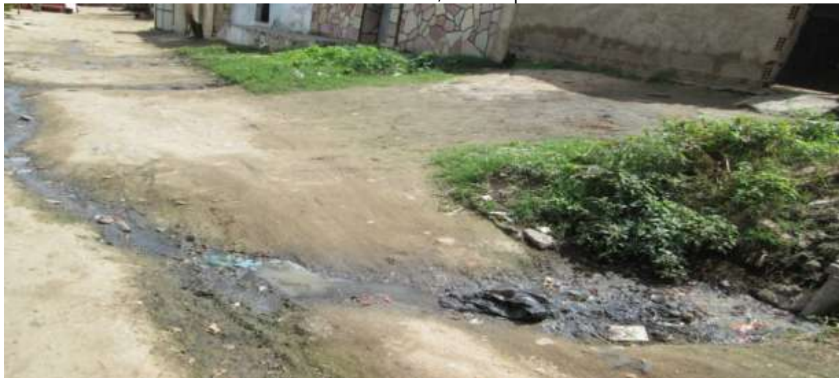
Figura 5: Esgoto correndo a céu aberto na rua da comunidade, no entorno do açude Bodocongó: comunidade Vila dos Teimosos, em Campina Grande-PB.
